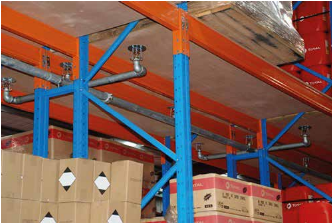
Figura 1 - Ejemplo de rociadores en estantería
