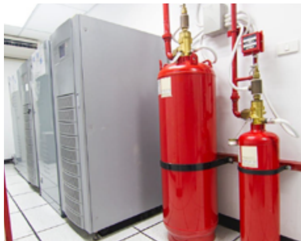
Figura 1: Ejemplo de sistema de agente limpio para protección de data center.
