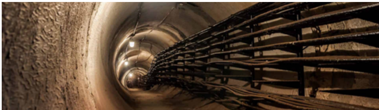
Figura 6: Ejemplo de túnel de cables
